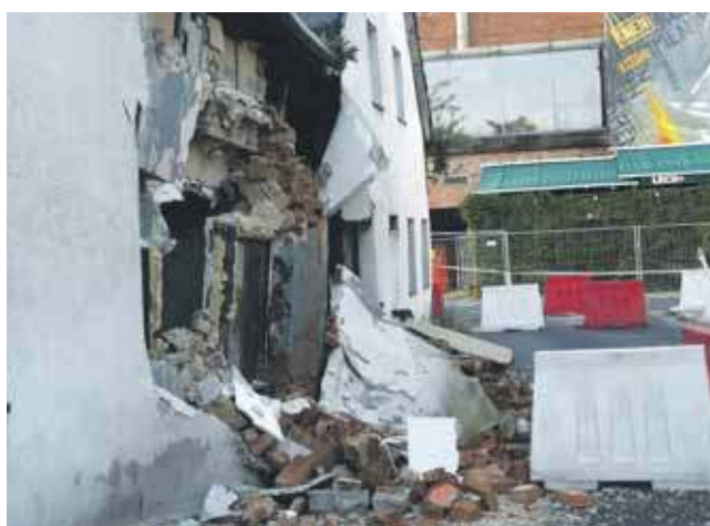
Prokurator uznał, że nikt nie mógł przewidzieć, że dojdzie do zawalenia się budynku Kurnej Chaty
