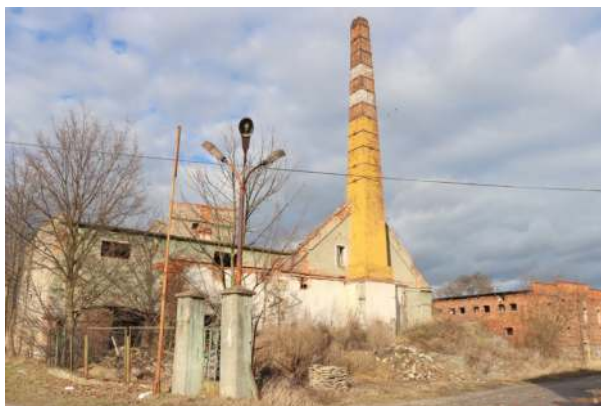
Czy budynek dawnej gorzelni w Przewornie grozi zawaleniem?
