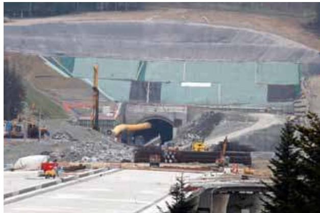
Z powodu prac przy drażeniu tunelu wyschła studnia pani Krystyny.
