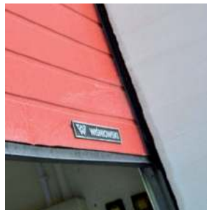
Uszkodzona brama garażowa
