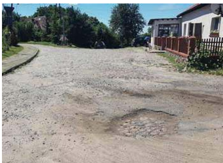
Droga w miejscowości Czerniki przed przebudową
