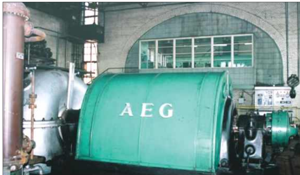
■ W roku 1915 na Annie wybudowano nową kotłownię i elektrownię z dwoma generatorami firmy AEG i wielkim zegarem elektrycznym tej samej firmy na ścianie hali
