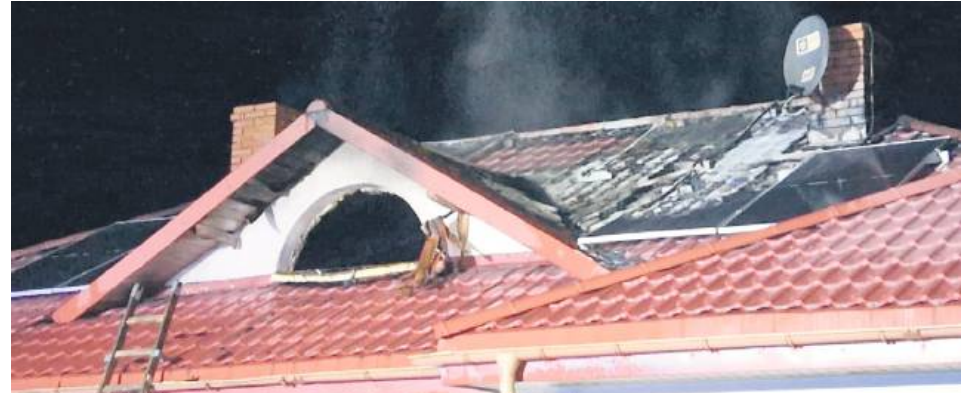
Zniszczeniu uległa instalacja fotowoltaiczna i część pokrycia dachu. Fot. kpt. Leszek Wrzyszczyński
