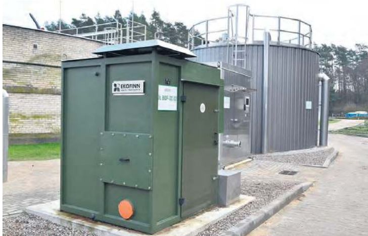
W newralgicznych miejscach na terenie oczyszczalni znajdują się zbiorniki z bio-filtrem (łącznie 5), które odciągają odory.
