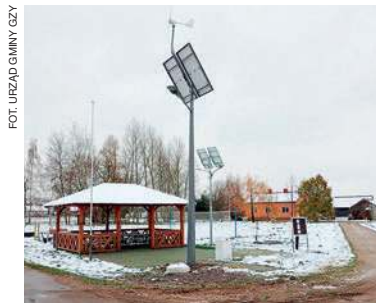
W gminie zamontowano sześnaście lamp
