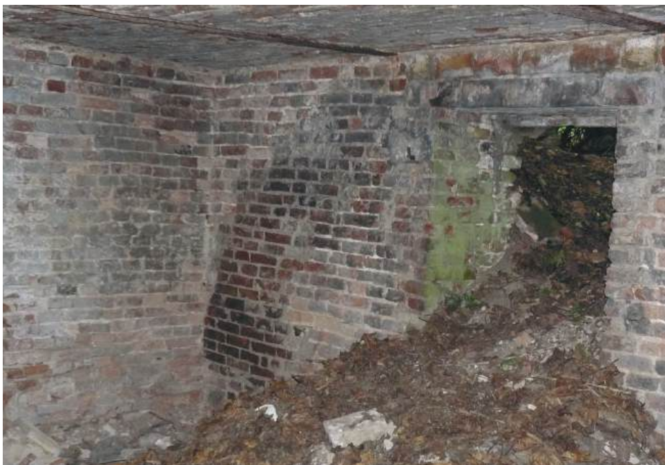
Stan piwnic dużego pałacu w Górze
