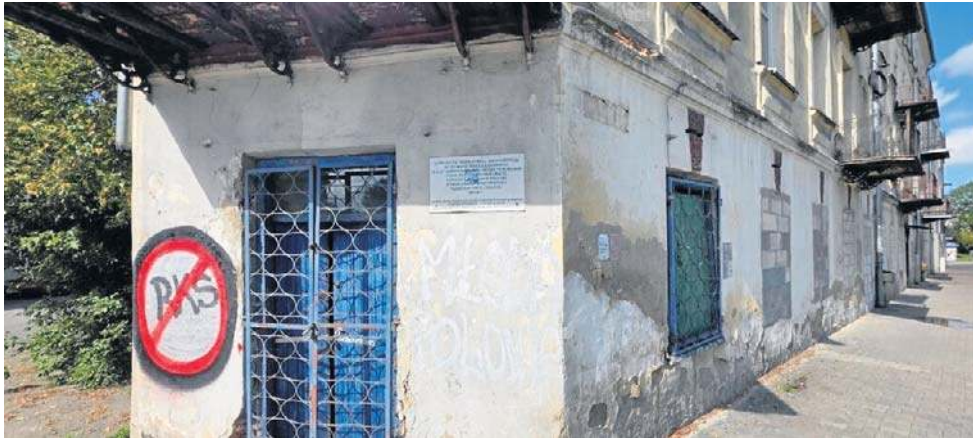
Jedna z kamienic przeznaczonych do remontu – stan budynku jest fatalny
