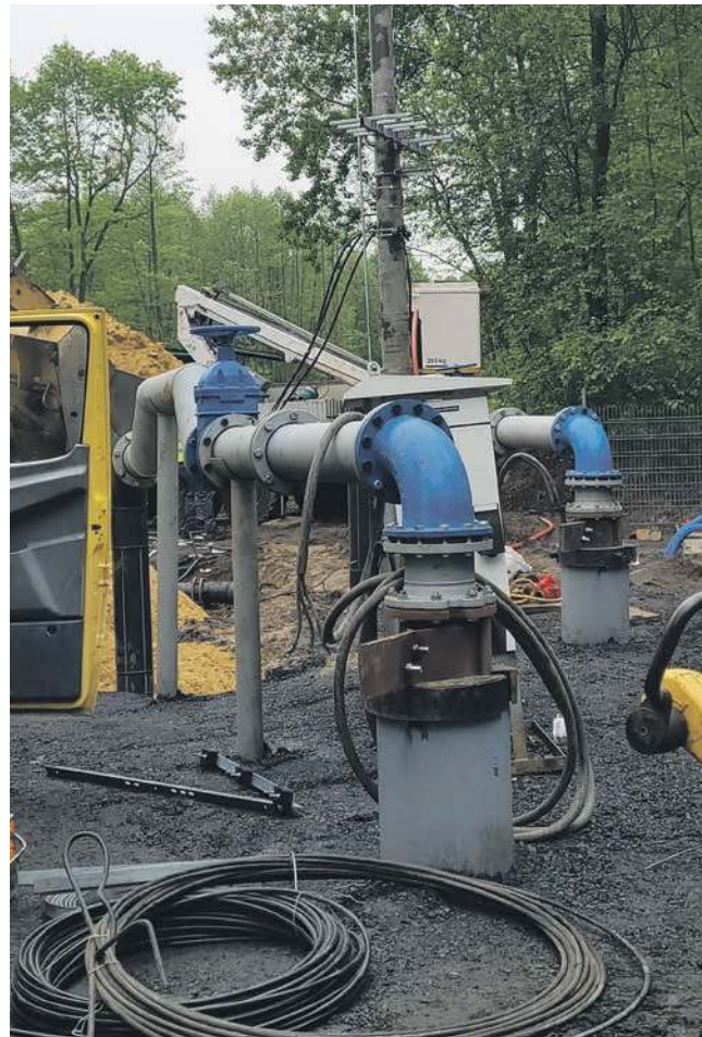
Urządzenia do pompowania wody z podziemi dawnej KWK Siersza ogłoszenie
