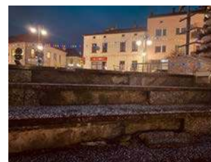
Tak wyglądają schody na płycie trzebińskiego rynku
