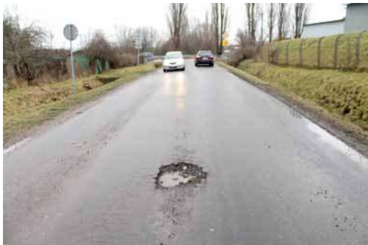
Tak wygląda dziura na ul. Składowej. Jest głęboka i znajduje się dość niefortunnie po środku leżącej między rowami drogi
