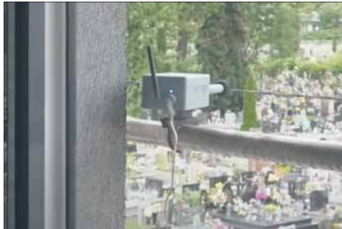
Urządzenie do monitorowania poziomu zanieczyszczeń
