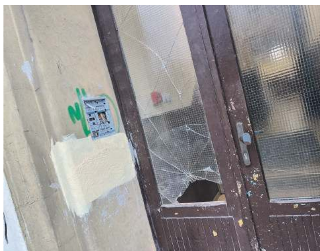
Tak wyglądają drzwi wejściowe do budynku przy ul. Obrońców Pokoju
