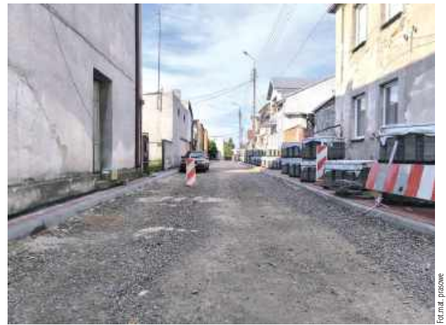
Niektóre drogi pilnie wymagały remontu
