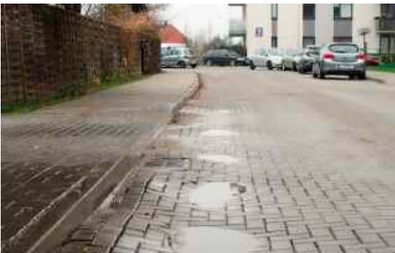
Deweloper ma czas na naprawę nawierzchni ul. Jemiółowej do końca tego miesiąca
