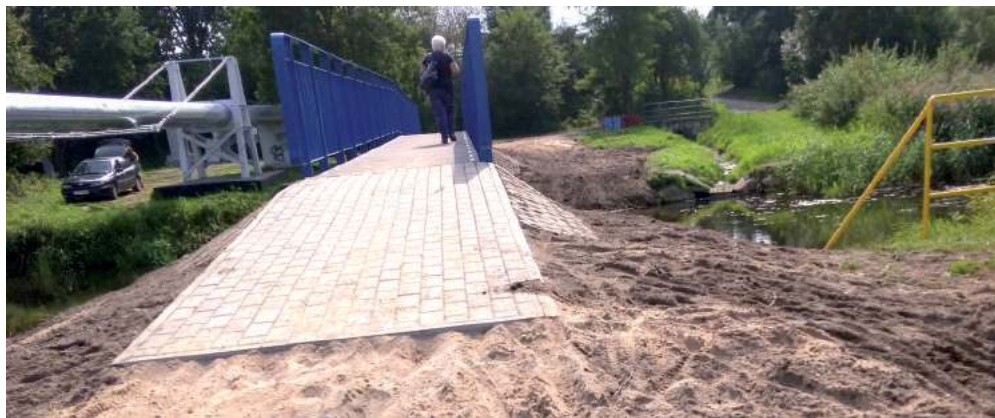
Wejście na kładkę (na przedłużeniu ul. Kąpielowej) od strony ul. Brzeskiej pozostawia wiele do życzenia
