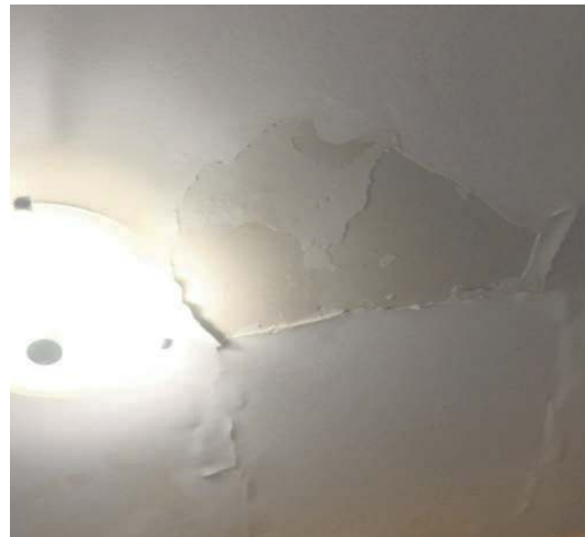
Zalany sufit zostanie wyremontowany
