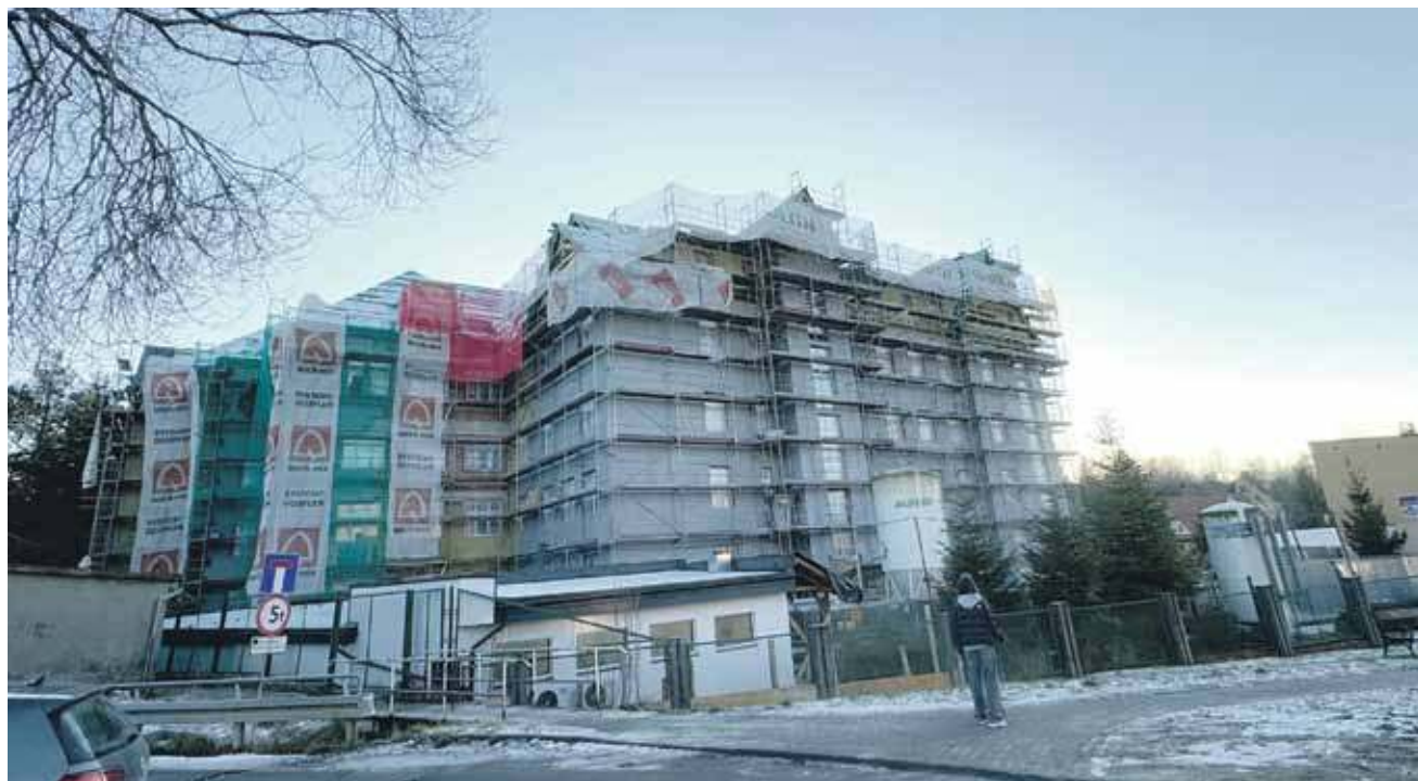
Budowa budynku Szpitala Miejskiego w Rabce-Zdroju może zostać wstrzymana.
