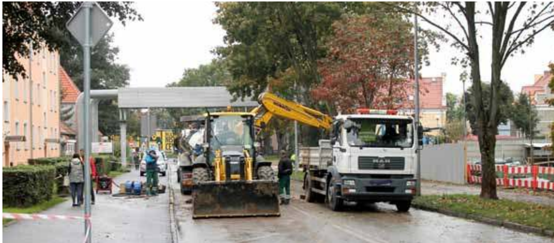
Teren, na którym doszło do awarii został wyłączony z ruchu
