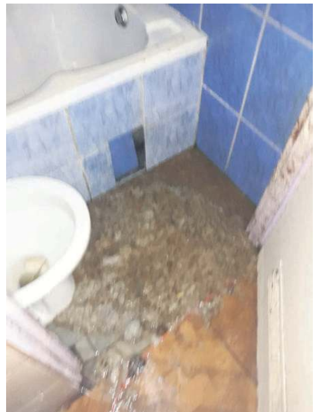
W budynku doszło do zatkania kanalizacji, w wyniku czego łazienka i kuchnia jednej z lokatorek została zalana fekaliami
