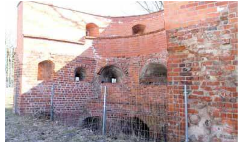
Basteja już na zewnątrz powinna zachęcać do jej obejrzenia. Wystające chaszczce a pod nimi warstwa śmieci to nienajlepsza wizytówka
