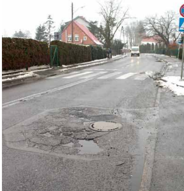
Jadąc ulicą Lotników miejscami trzeba bardzo uważać, by nie wpaść kołem w taką oto dziurę
