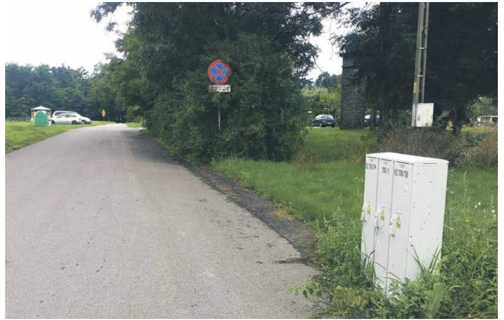
Pan Choptiany pokazuje też inną nową skrzynkę, którą postawiono tuż przy asfalcie. - Przecież tak się nie robi - mówi. - To za blisko, będzie przeszkadzać. A w zimie jak plug będzie chciał odśnieżyć, to zniszczy. Tu trzeba myśleć!
