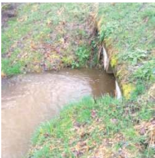
Woda z przepustu wypływa wprost na prywatną posesję powodując jej zalanie
