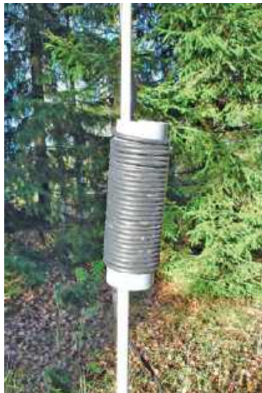
Fot. 4. Umocowanie dławika dla zmniejszenia jego obciążenia mechanicznego. Na jego szczycie występują wysokie napięcia w.c. i dlatego powinien on się znajdować możliwie wysoko nad ziemią
