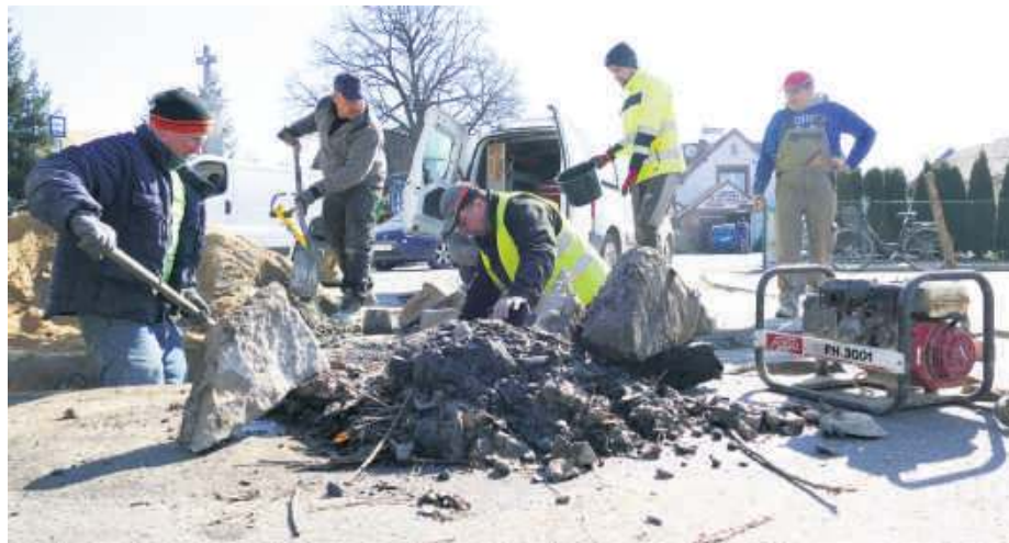
Widoczne na pierwszym planie fragmenty betonu, kamieni i błota zalegały w kanalizacji burzowej, odprowadzającej wodę z kilkakrotnie zalewanych posesji przy ul. Strzeleńskiej
