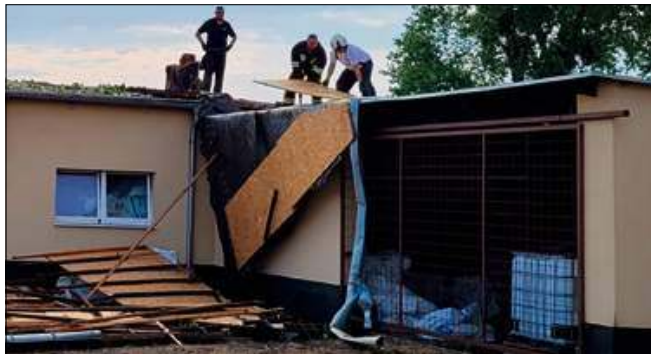
Zniszczeniu uległ dach budynku w Choruli.
