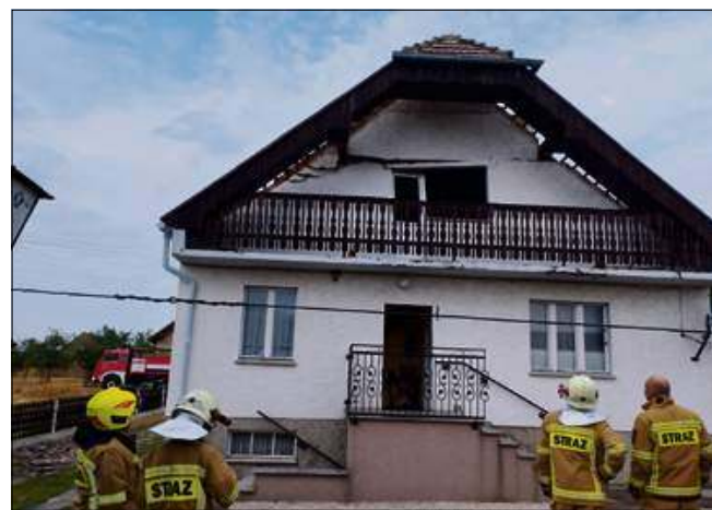
W domu w Strzeleczkach uszkodzony został dach i ściana szczytowa.
