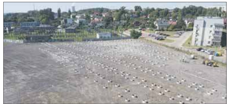
Na działce ma stanąć ponad 12 tys. paneli fotowoltaicznych
