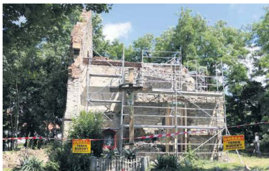
Gmina Wiązów otrzymała 50 tys. zł dotacji na zabezpieczenie ruin kościoła ewangelickiego w Miechowicach Oławskich
