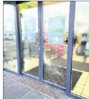
Z ustaleń mundurowych oraz zapisu monitoringu wynikało, że agresor nie zamierzał wejść do sklepu, a uszkodzeń dokonał tuż przed otwarciem, uderzając w drzwi metalowym elementem znaku informacyjnego
