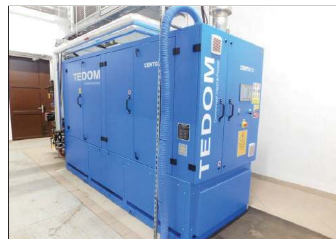
Aggregat kogeneracyjny to urządzenie służące do produkcji energii elektrycznej i cieplnej z biogazu wytworzonego w oczyszczalni ścieków Karkoszka II. Moc agregatu wynosi 200kW.
