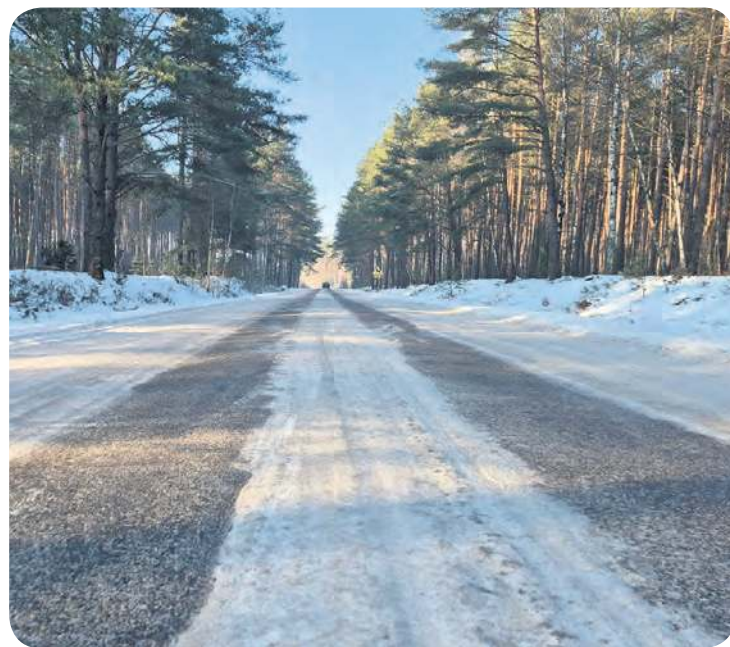
22 stycznia droga powiatowa pokryta była warstwą lodu.
