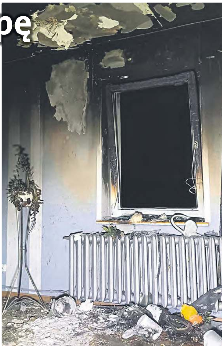
G. Zniszczenia w miejscu, w którym doszło do pożaru. Fot. OSP KSRG Kęsowo
