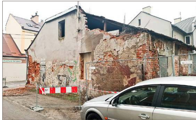
Stan budynku przy ul. Wielopolskiej pozostawia wiele do życzenia.
