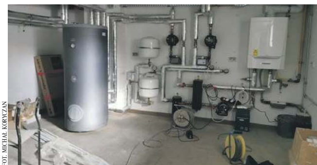
Zmodernizowana kotłownia w remizie
