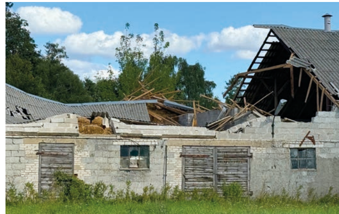
Zerwany dach stodoły w okolicach Niestumia
