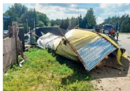
Dach przy drodze Lubowidz-Galumin
