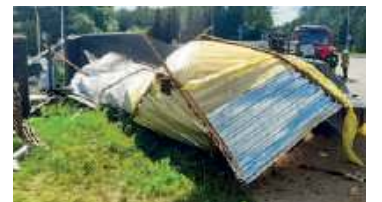
Dach przy drodze Lubowidz-Galumin
