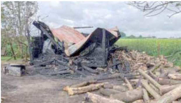
Drewniany budynek doszczętnie spłonął, a po ugaszeniu pożaru w środku odnaleziono zostały częściowo zwęglone zwłoki 67-letniego mężczyzny
