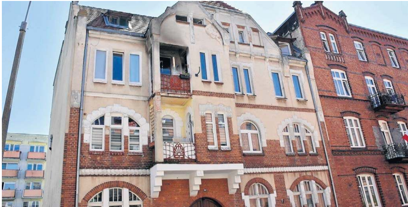
Do pożaru doszło na drugim piętrze tej kamienicy. Droga ucieczki była odcięta przez podłożony ogień. Dwie kobiety i dwoje dzieci strażacy ewakuowali w koszu drabiny
