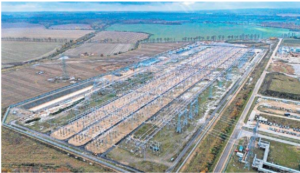
Stacja w Choczewie jest gotowa do odbioru mocy z morskich farm wiatrowych
