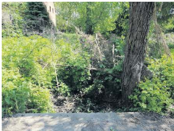
Zaniedbane rowy na ul. Brzegowej w Strzelinie
