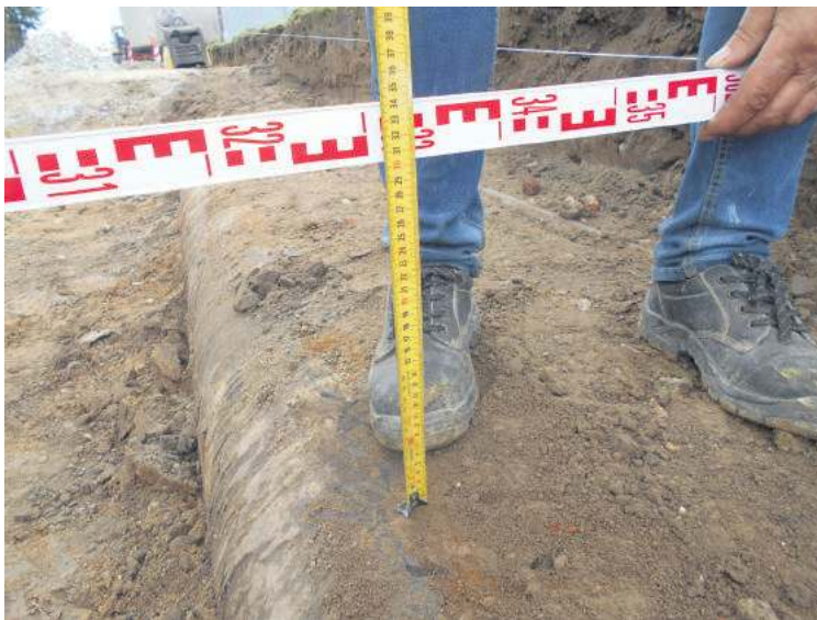
Drogowców zaskoczyła płytko położona rura z gazem, której w tym miejscu drogi nie powinno być
