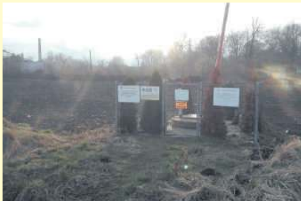
Pompownia w Prusach jest istotnym punktem sieci kanalizacyjnej w gminie Kondratowice
