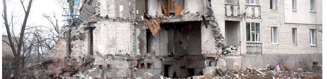
Donbas, Ukraina. Zniszczony budynek mieszkalny
