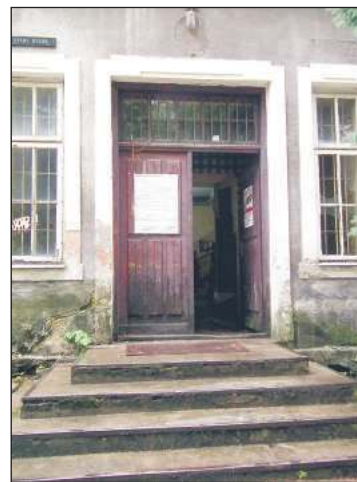
Budynek stoi pusty i niszczeje.
