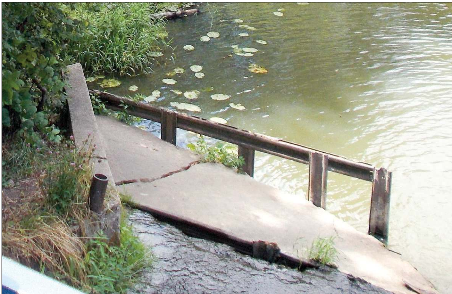
■ Największym zmartwieniem użytkowników mostu są pęknięcia przyczółków. Dawniej były zalane betonem, ale ten zaczął się kruszyć. Teraz warto go wzmocnić
