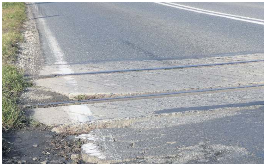
Ubytki w nawierzchni ul. Wrocławskiej w Strzelinie powiększają się z tygodnia na tydzień
