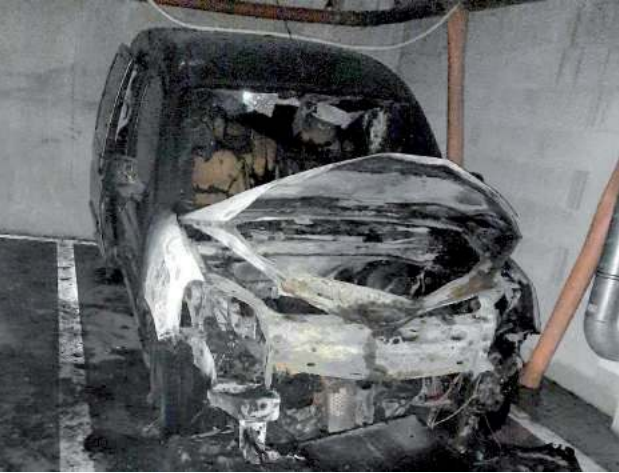
Osobowy citroen spłonął doszczętnie. Ucierpiało także auto zaparkowane obok oraz instalacja sanitarna i elektryczna w garażu podziemnym
